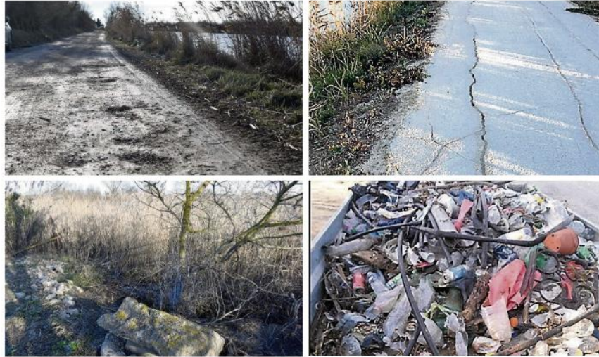
Nids-de-poule, fissures, roubines obturées et déchets à gogo, les autres visages du canal et de ses abords.
